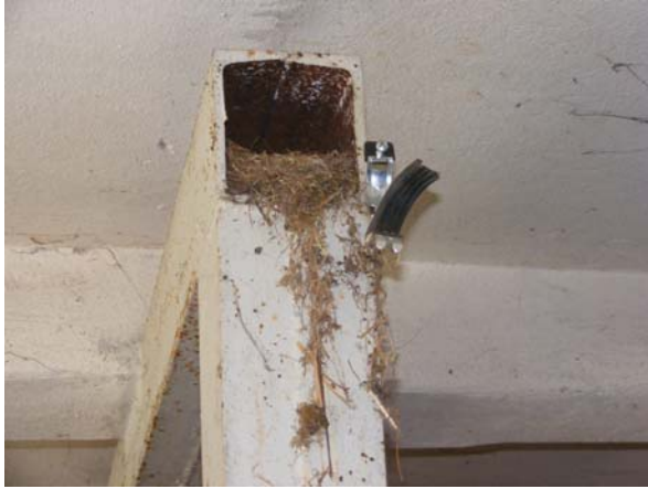
Nest im verschlossenen Nebengebäude
