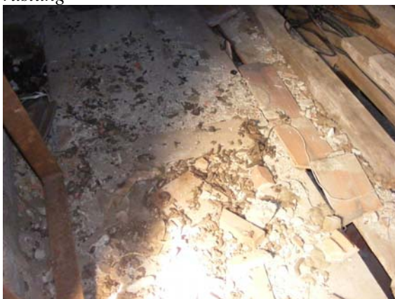
Marderkot im Dachboden des Nebengebäudes
